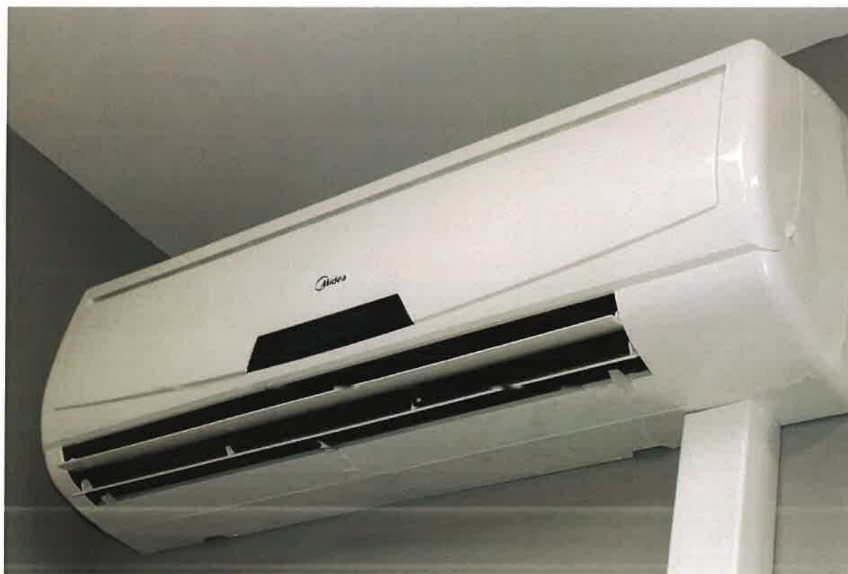
Zdjęcie 4 – Urządzenia klimatyzacyjne w serwerowni 1
